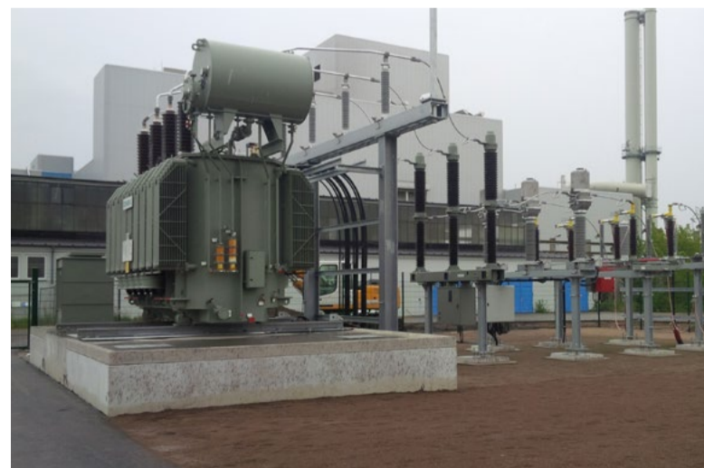
Kommen Sie drauf? Wo befindet sich dieses Umspannwerk der EVC?
