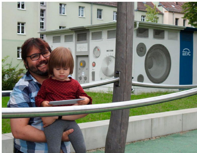
Holger Bergmann hat es gewußt: Die Trafostation der EVC schmückt den Fontaneplatz. Gemeinsam mit Tochter Holly hat er einen der begehrten Cottbuser Geschenkgutscheine gewonnen.
