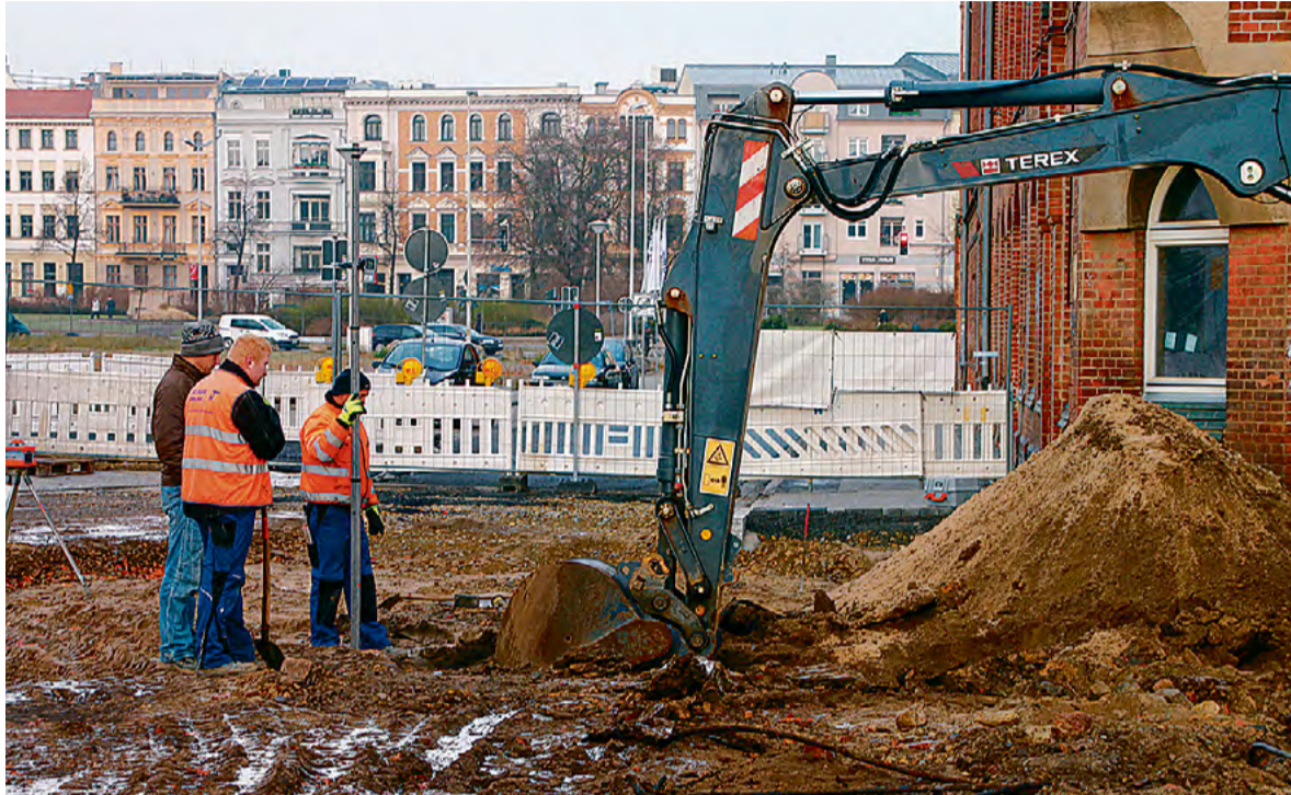
Verlässliche Informationen über die genaue Lage von unterirdisch verlegten Leitungen sind für den sicheren Betrieb auf Baustellen unabdingbar. Leitungsinformationen und Schachtscheine gibt es übrigens kostenfrei.
